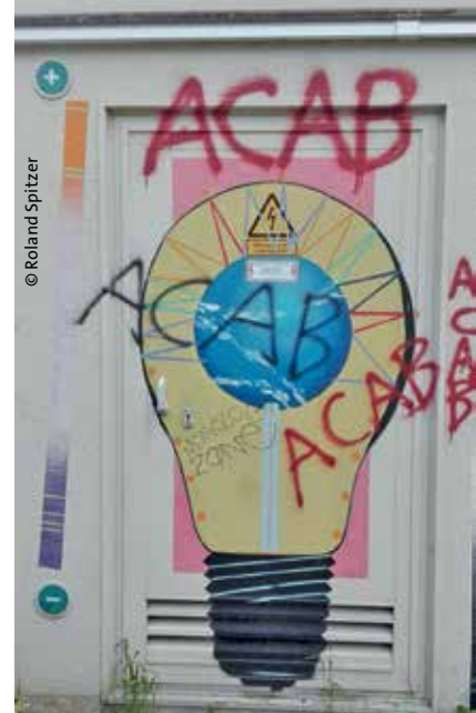
► Der ACAB-Schriftzug an einem Stromverteiler der Stadtwerke wird seit mindestens zwei Jahren geduldet.
